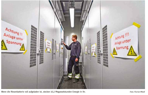
Wenn die Reserverbatterie aufgeladen ist, stecken 10,2 Megawattstunden Energie in ihr.
