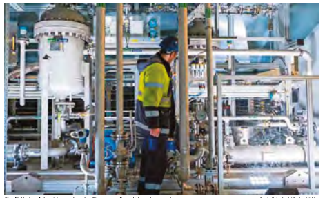
Eine Elektrolyse-Anlage ist enorm komplex. Sie muss von Spezialisten betreut werden.
